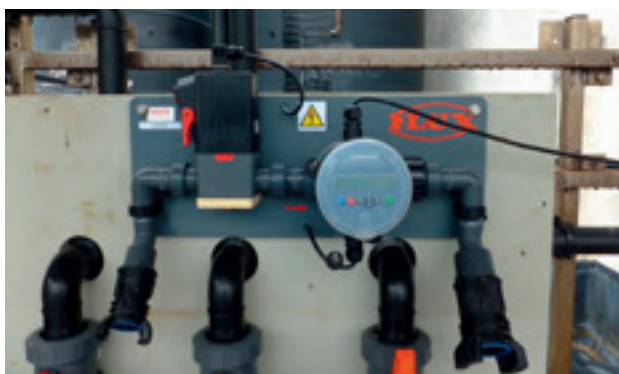
FMC 100 avec amplificateur de commutation FSV 100 monté sur une conduite pour un remplissage semi-automatique.
