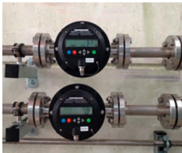
FMO 150 avec raccords à bride, monté sur une conduite.
